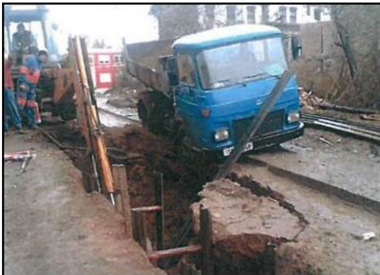
Obr. 4: Utržená stěna výkopu po zatížení vozidlem. Na obrázku je zároveň patrná nevhodná instalace pažení a umístění žebříku. (zdroj: materiály VÚBP, v. v. i.)
