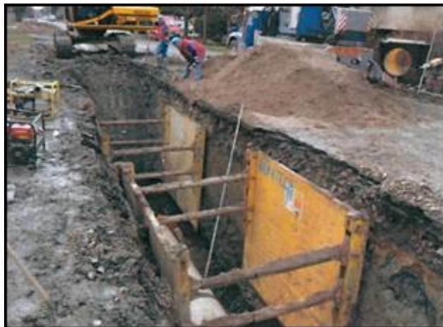
Obr. 6: Zapažený výkop, avšak zaměstnanec se pohybuje v ohroženém prostoru bagru. (zdroj: materiály VÚBP, v. v. i.)
