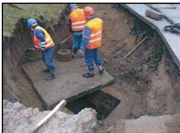
Obr. 5: Práce v nepaženém výkopu. Zároveň probíhá podhrabávání stěny výkopu. (zdroj: materiály VÚBP, v. v. i.)
