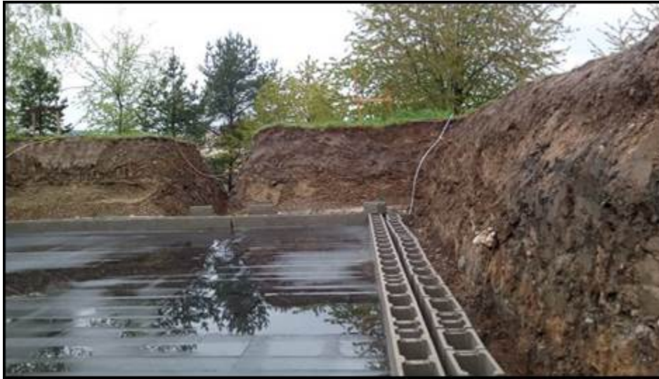
Obr. 10: Stavební jáma je nedostatečná. Chybí prostor pro manipulaci kolem bednění v době, kdy bude prováděna montáž hydroizolace. Pro případné svahování již na pozemku nebyl dostatečný prostor. (zdroj: materiály VÚBP, v. v. i.)
