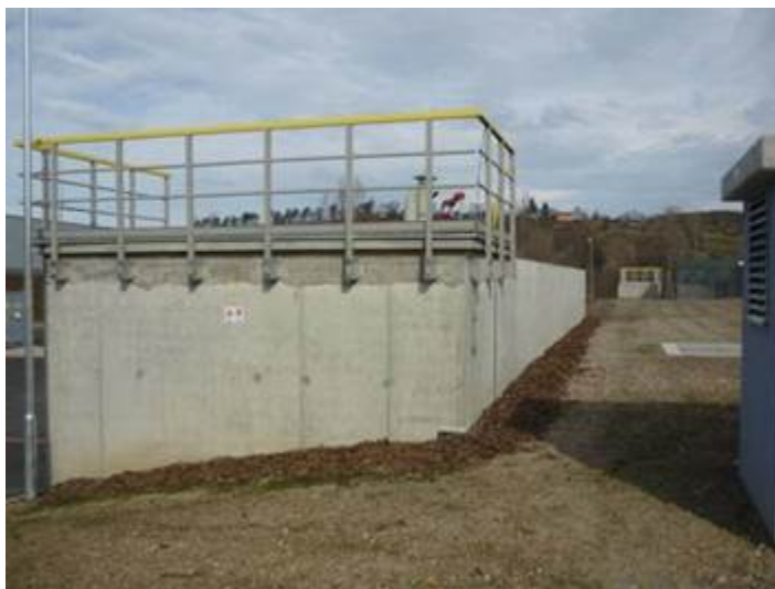
Obr. č. 3: Příklad kůrového filtru (Regenerace) nad biologickou částí NVL ÚČOV Praha (vlevo) a příklad kůrového filtru nacházejícího se u západní fasády podzemní části NVL ÚČOV Praha (vpravo) (foto: VÚBP, v. v. i.)
