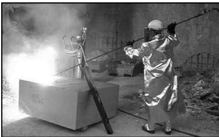
Obr. č. 15: Příklad použití kyslíkového kopí při řezání betonu. Z obrázku je zřejmé, že kyslíkové kopí není opatřeno žádným ochranným štítem a jeho držení je tak možné i za vlastní tyče kopí. (foto: [7])
