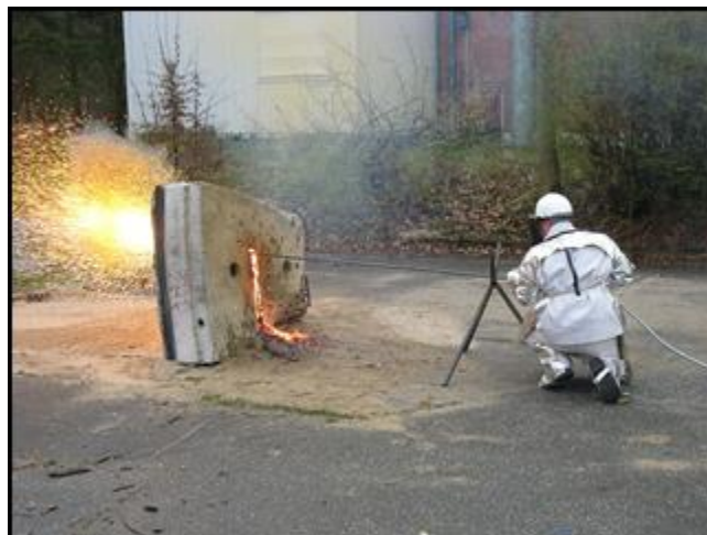
Obr. č. 11: Příklad použití kyslíkového kopí při řezání betonu. Z obrázku je zřejmé, že kyslíkové kopí není opatřeno žádným ochranným štítem. (foto: [10])
