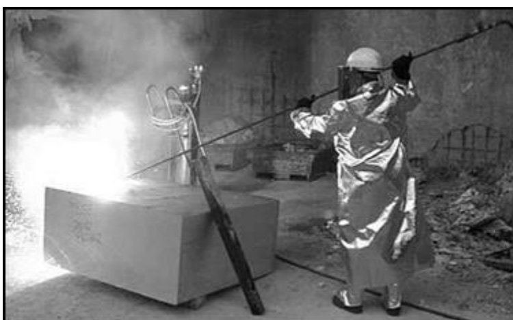
Obr. č. 15: Příklad použití kyslíkového kopí při řezání betonu. Z obrázku je zřejmé, že kyslíkové kopí není opatřeno žádným ochranným štítem a jeho držení je tak možné i za vlastní tyče kopí. (foto: [7])
